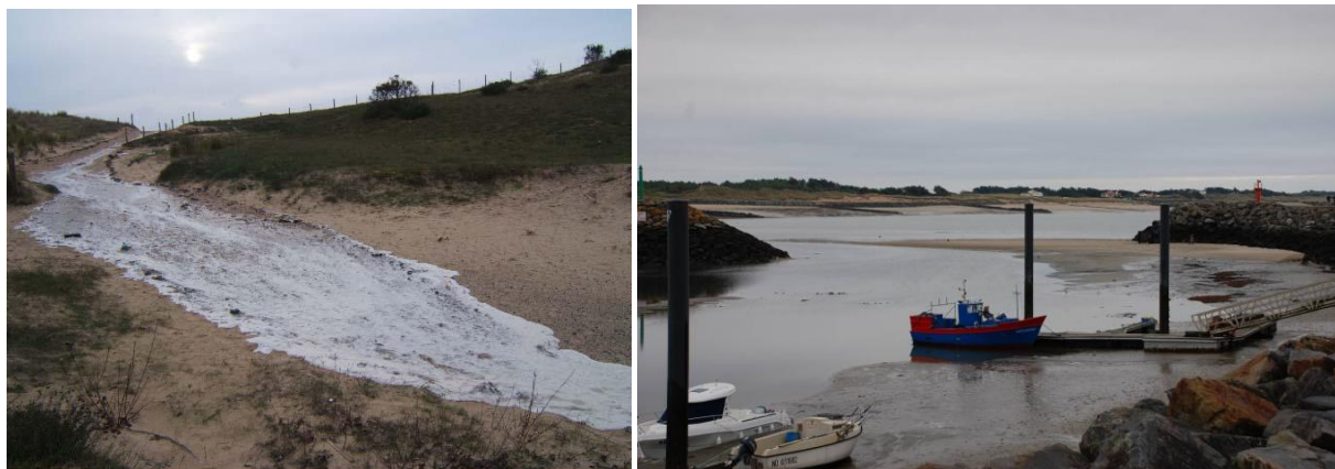
Les protections ne suffisent plus à empêcher le franchissement de la dune par la mer. Le transit naturel ensable régulièrement l'entrée de port (source : la Vigie)
